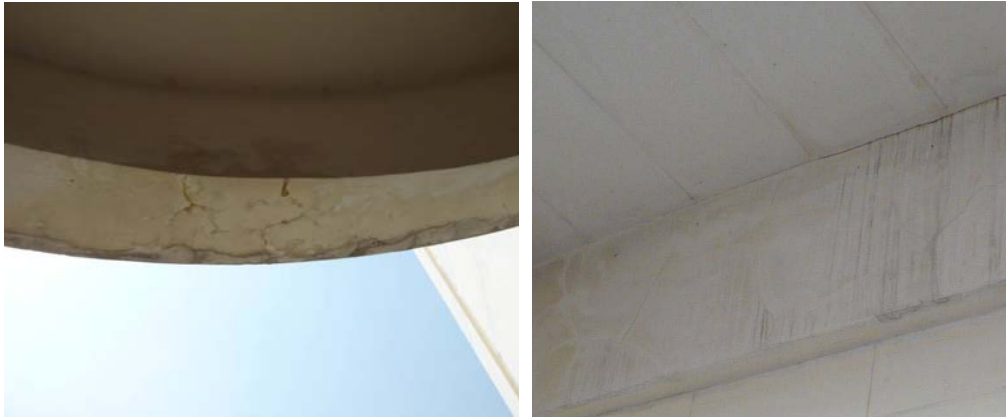
รูปที่ 7: การรั่วซึมของน้ำ
